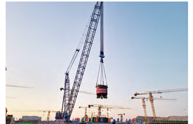
近日,徐大堡核电站4号机组堆芯捕集器壳体容器顺利吊装就位。本次吊装的堆芯捕集器壳体容器位于堆芯竖井底部,是核电站安全的重要保障,也是堆芯竖井内的大型设备之一。(何讯)
